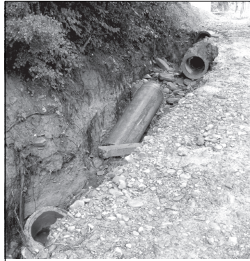
Те, що залишилось від водовідведення на вулиці Фенчука
